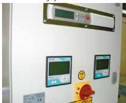
Slika 5 Merilnika električne energije vgrajena v elektro krmilno omaro
